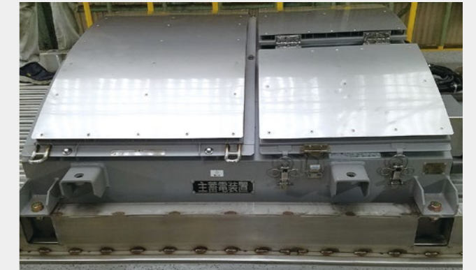
写真3：主蓄電池装置（屋根上）
